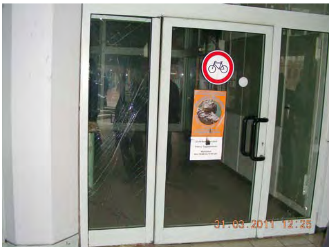
Türen und Scheiben beschädigt
