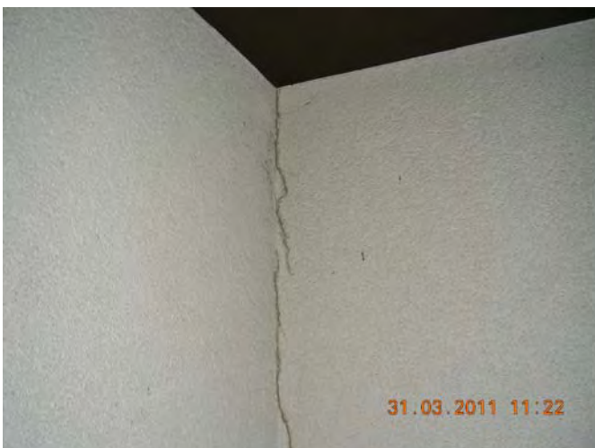
Alter Riss im Foyer
