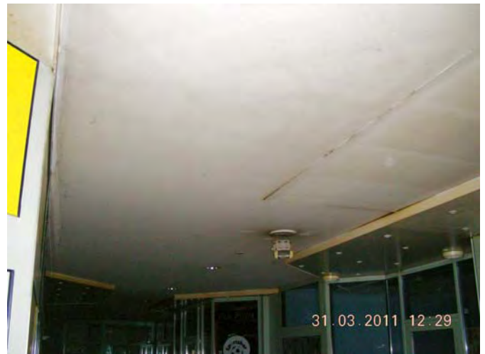
Decken Mallbereich - starke Gebrauchsspuren
