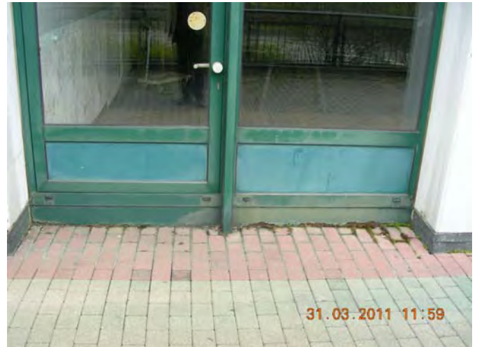
Türelemente Läden Südwestseite - unten stark angerostet
