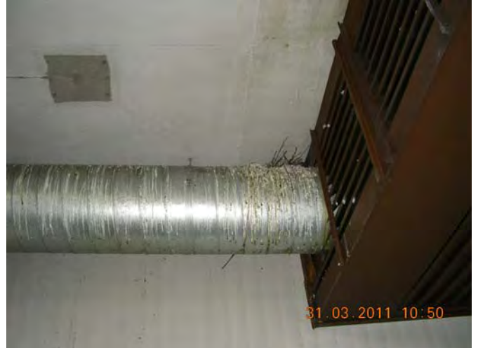
Lüftungsrohr im UG
