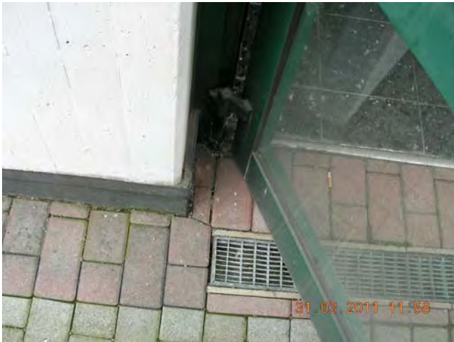
Türe Treppenhaus beim FA - Fuge Verwahrung offen
