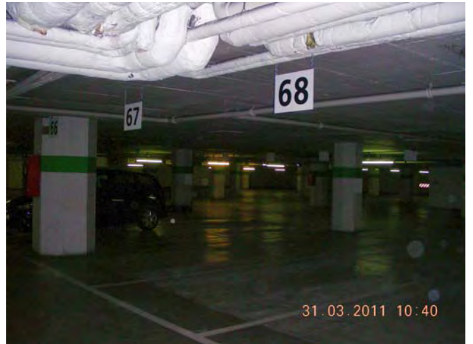
Leitungen an Tiefgaragendecke
