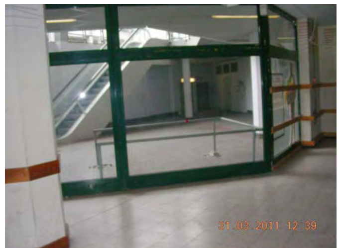
Rolltreppe im Aussenbereich Basement
