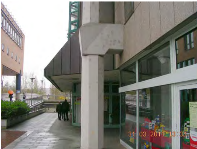
Aussenstützen - Wärmebrücken / Ostseite
