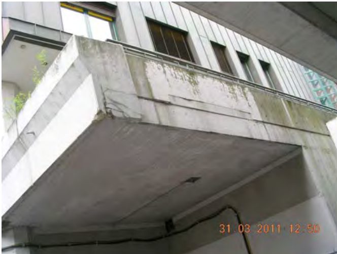
Schäden - Anlieferungsbereich vermutlich durch LKW
