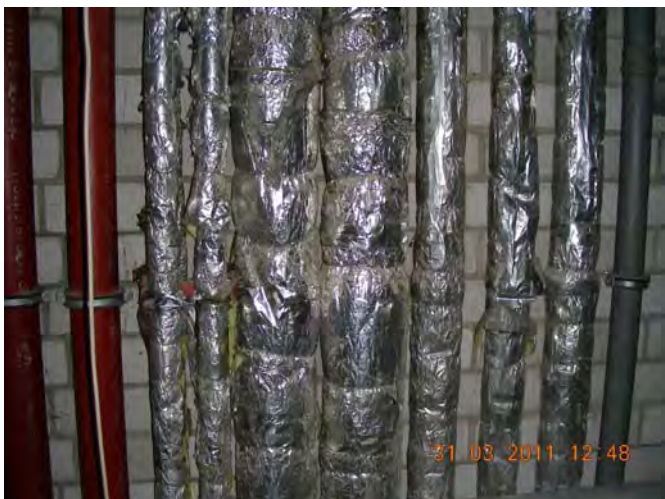
Steigschacht - manche Leitungen relativ neu
