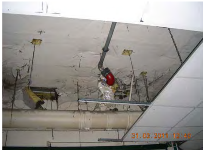
Leitungen unter der Decke
