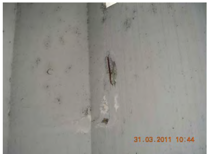
Leichte Abplatzungen im Treppenhaus
