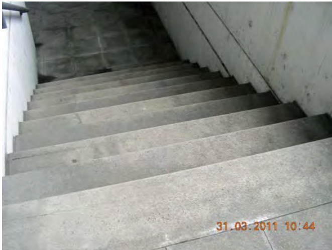
Treppenstufen mit Schäden
