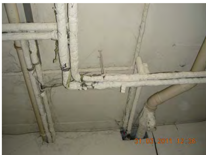
Isolierung stark beschädigt
