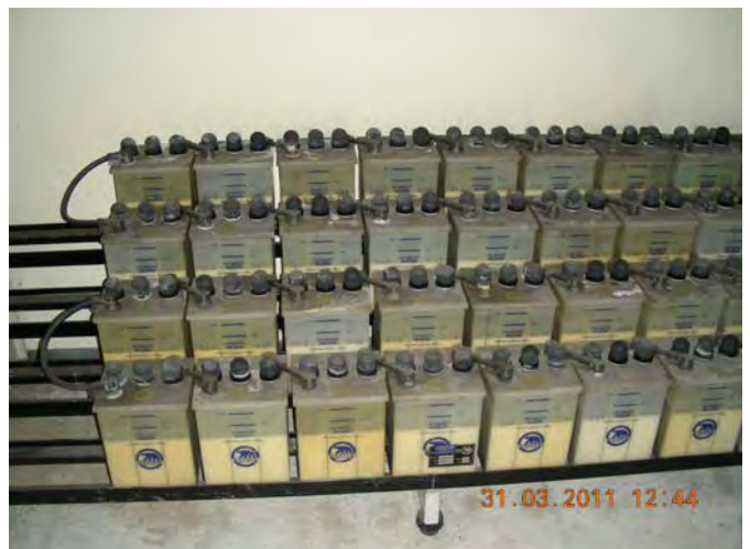
Batterieraum Laden Basement
