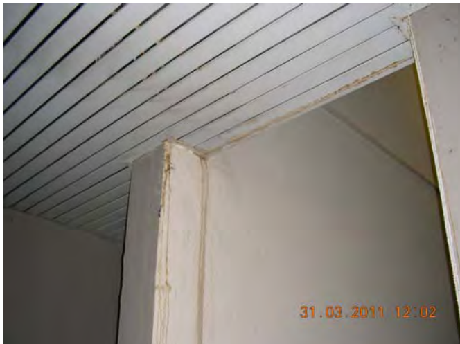
Undichte Stelle unter Treppenlauf
