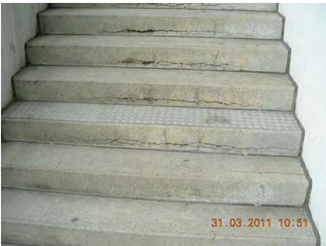
Treppenstufen mit Schäden
