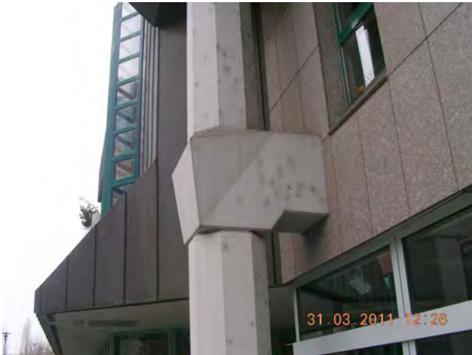
Außenliegende Stützen - sind Wärmebrücken
