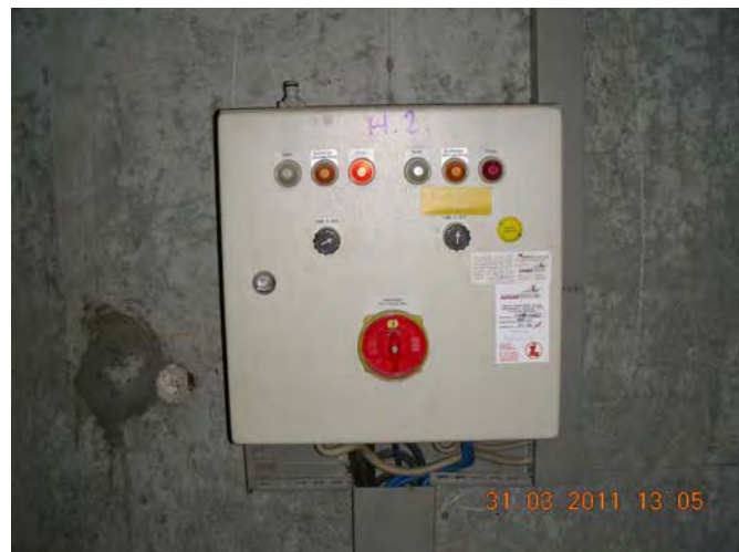
Hebeanlage steht auf Störung
