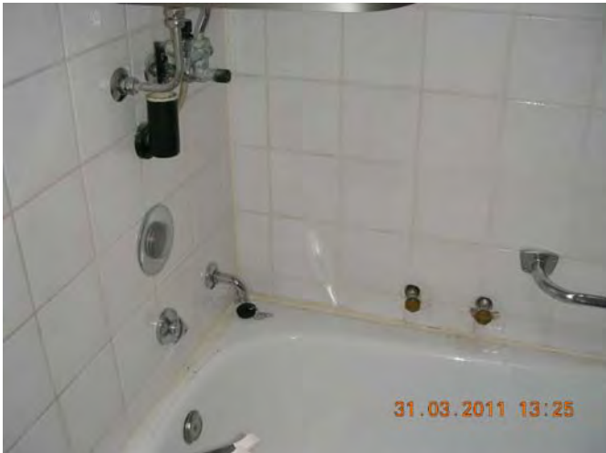
Bad leerstehende Wohnung
