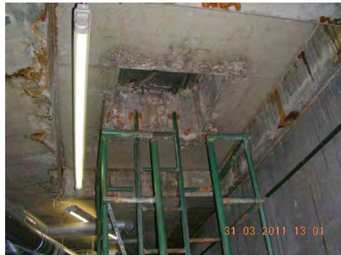
Ausstieg aus Heizraum
