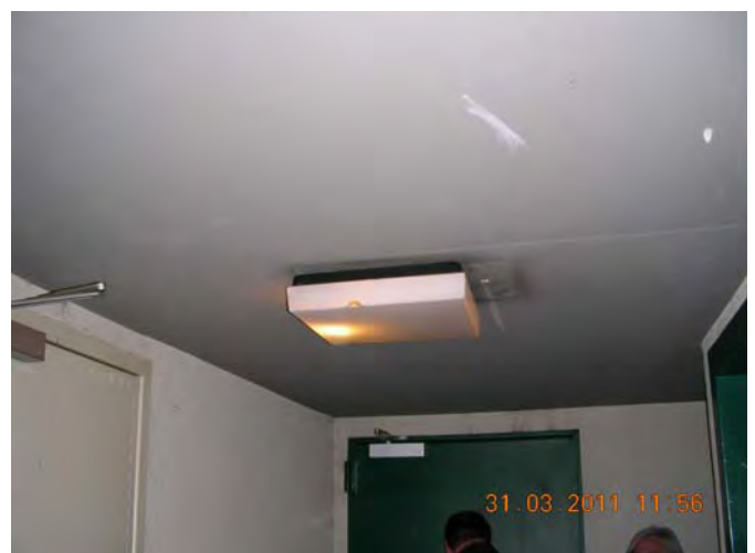
Beleuchtung Treppenhaus sehr schwach
