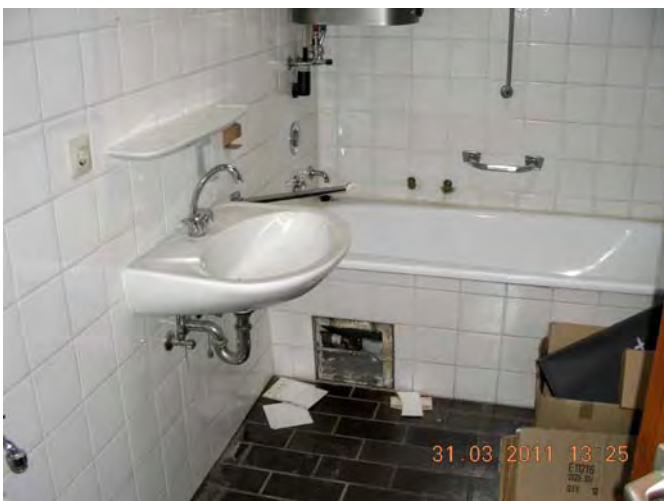
Bad leerstehende Wohnung
