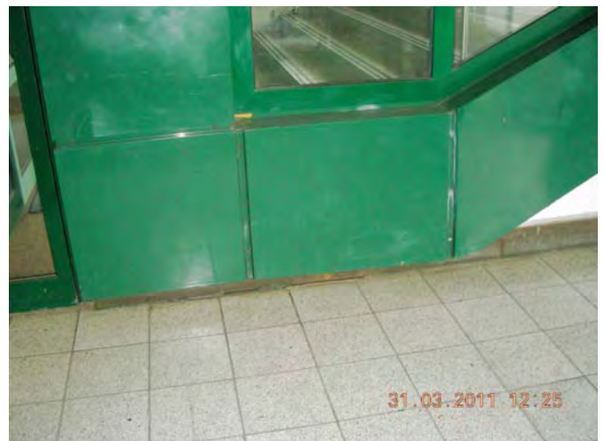
Fensterelemente unten stark angerostet
