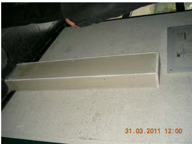
Verkleidung Leitungen im Treppenhaus
