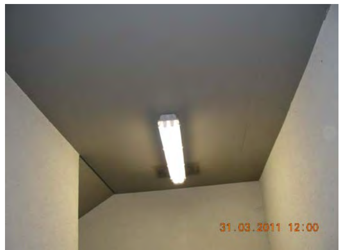
Nachgerüstete Leuchte im Treppenhaus
