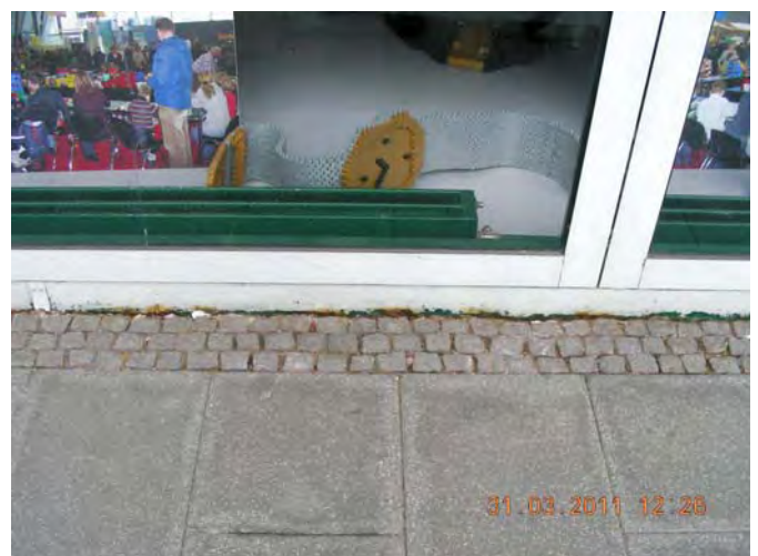
Fenster unten angerostet
