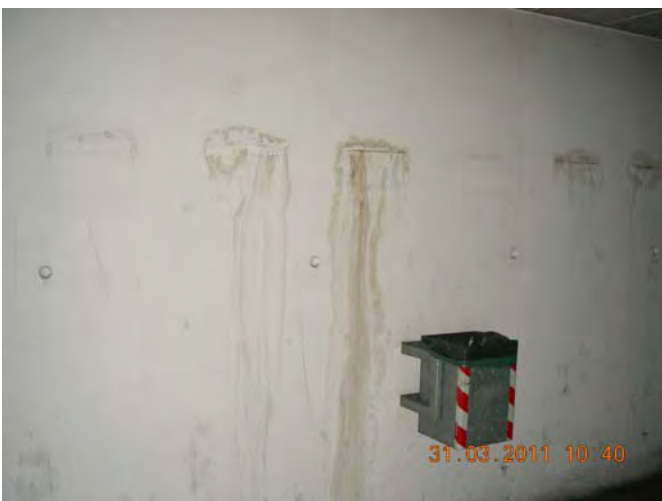
Alte Undichtigkeiten in TG
