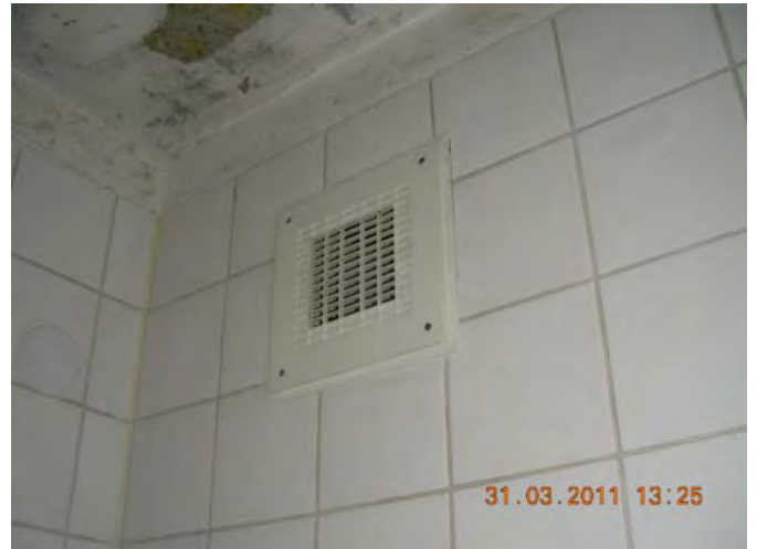
Badlüfter leerstehende Wohnung
