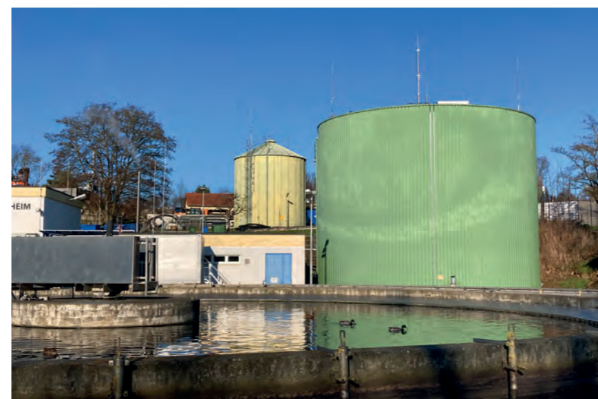
PV-Faulturm des Eigenbetriebs Stadtentwässerung
