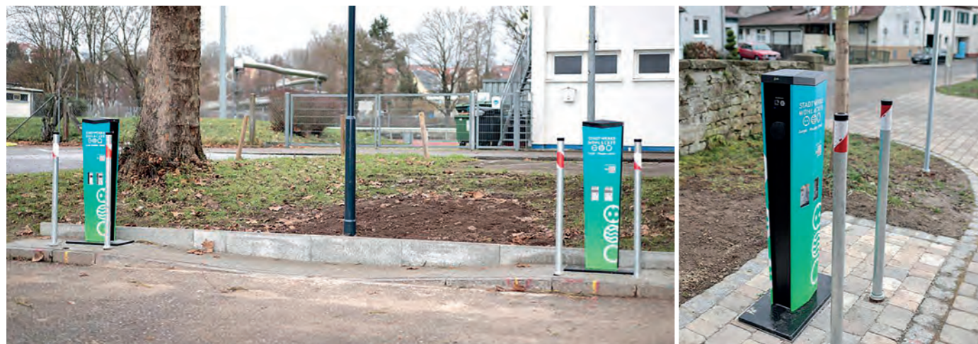
E-Ladeinfrastruktur in Mühlacker
